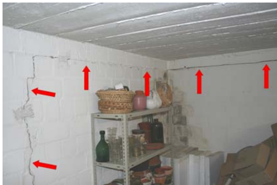
Bild 1: Kellergeschoss, Wandrisse und Mauerwerksverschiebung
