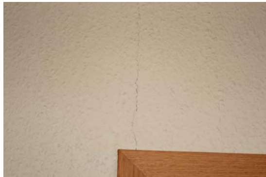
Bild 4: Erdgeschoss, Wohnzimmer, Wandriss
